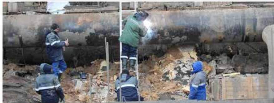
Une équipe des infrastructures de Kyïv en train de réparer une conduite d'eau endommagée par une attaque de drone ou de missile russe
