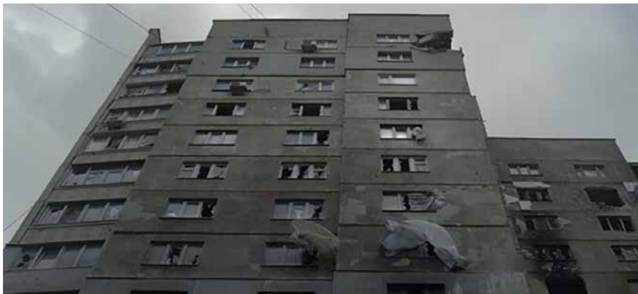
10. «Chants de la terre qui brûle lentement»: immeuble bombardé aux rideaux flottants.
